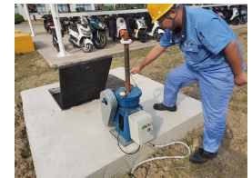
⑤ 关闭雨水总排口 方法二：手动
